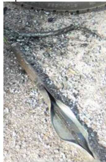
(Fig. n.92) deformazioni da scoppio di pistoni pneumatici
